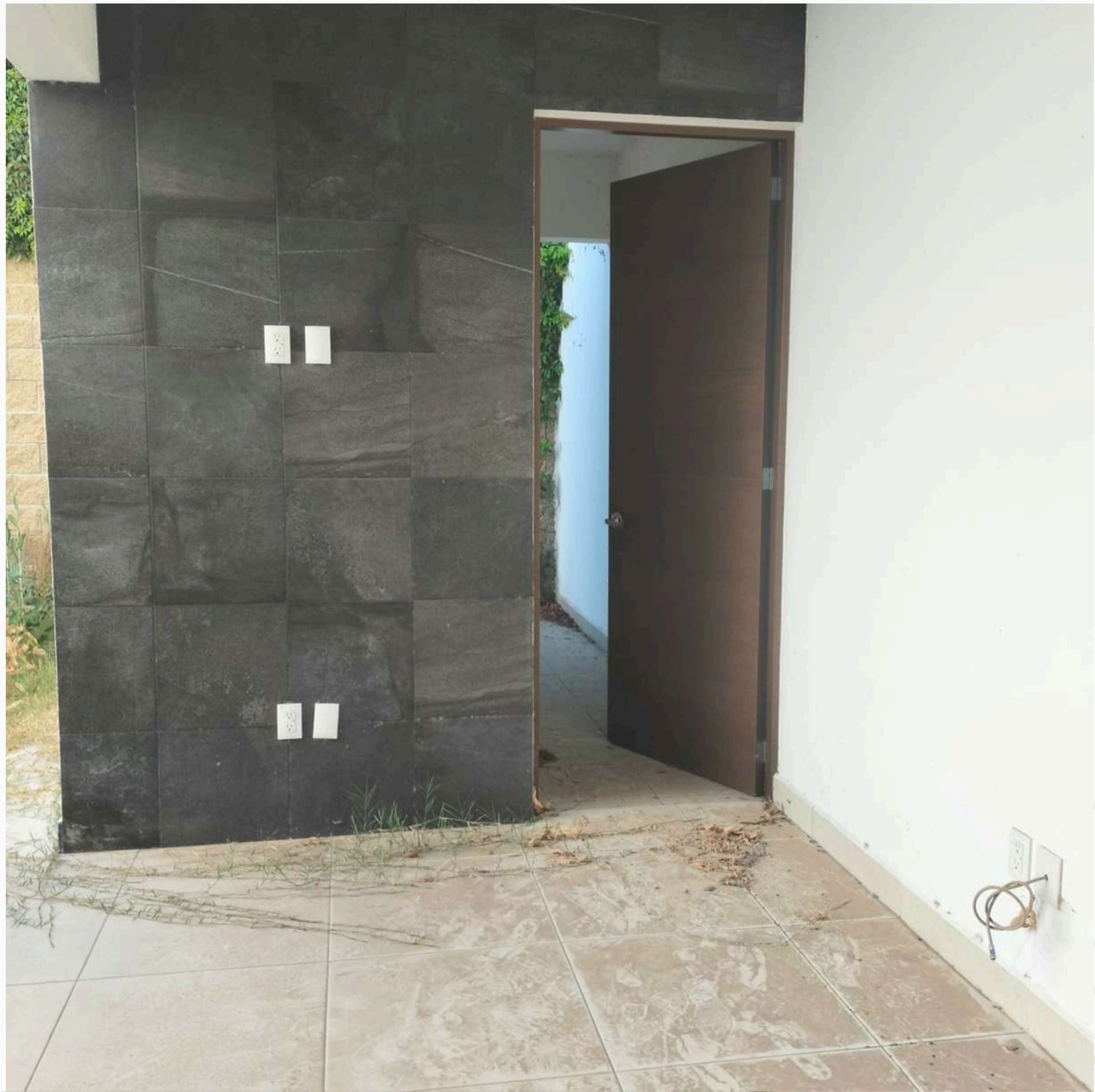
Área de Lavado techado
